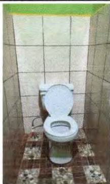
Foto 7: Sustrucción de inodoro y azulejo de todo el establecimiento educativo.
